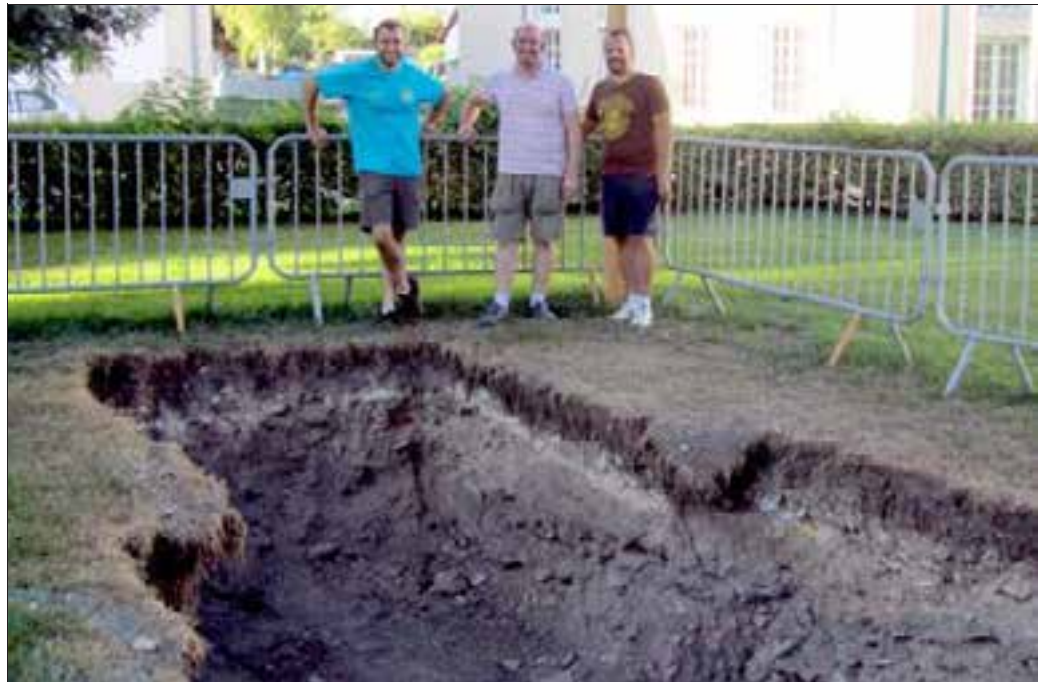
Les quatre cloches seront coulées sur place ; la fosse qui accueillera les moules et le four est déjà prête. Photo RL
